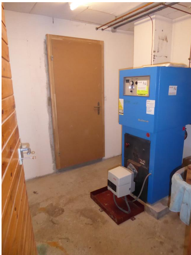
Chaudière à mazout
