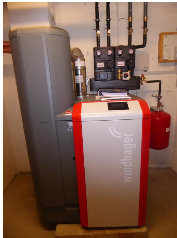
Chaudière à pellets
